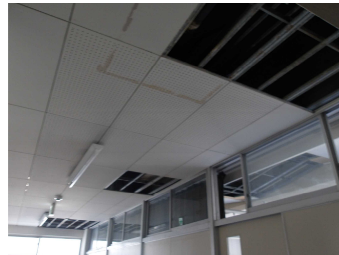
廊下：天井の漏水
