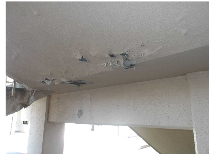
階段裏：塗装の剥離、剥落 14
