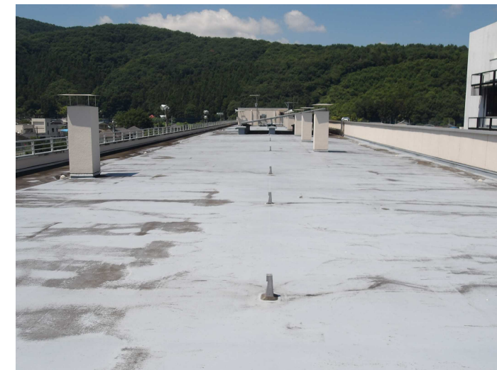
屋上：防水層の汚損
