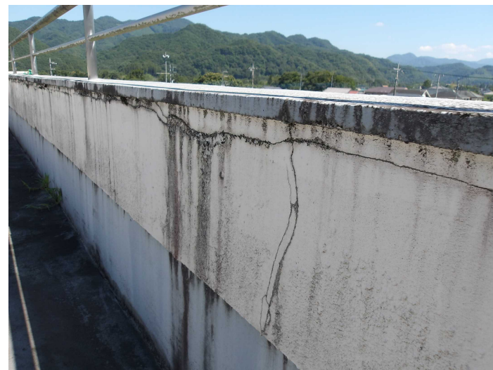
↑ パラペットのき裂、損傷
