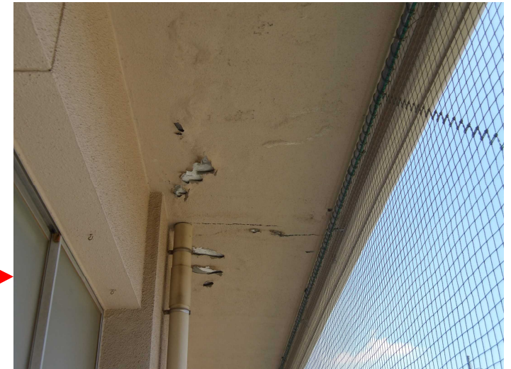
軒裏：塗装の剥離、剥落
