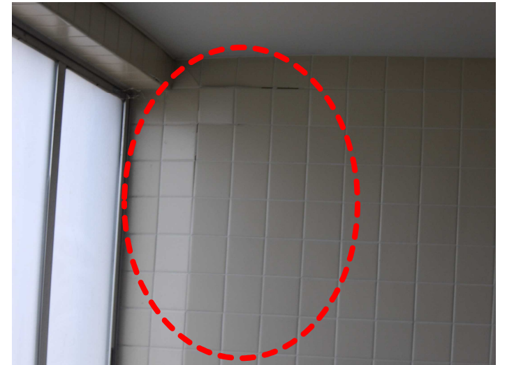
男子トイレ：内壁タイルの浮き
