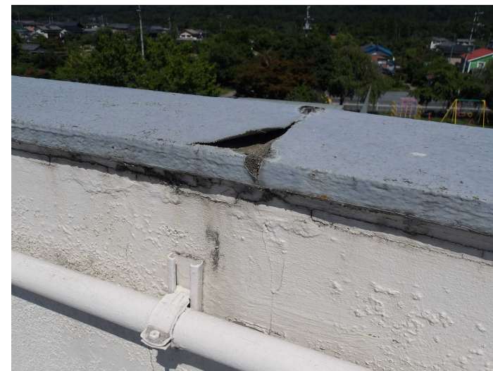
↑ 塗膜防水の剥離
