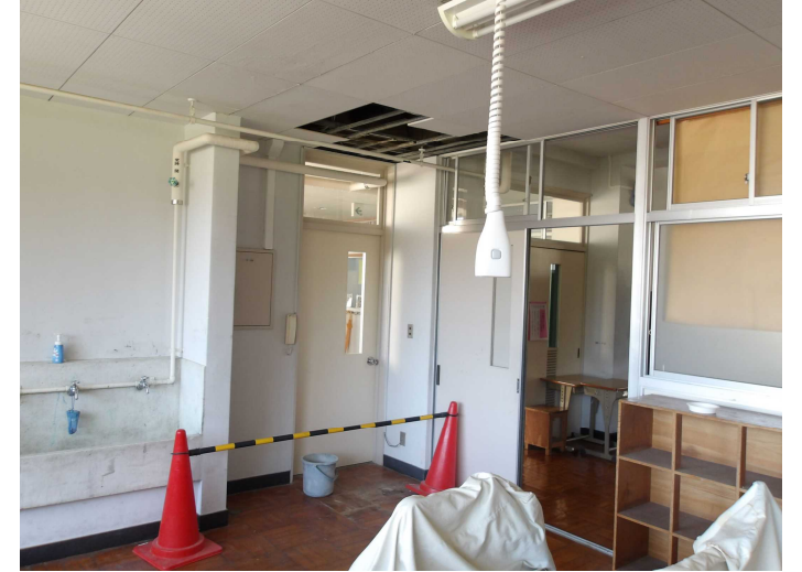
教室：天井の漏水
