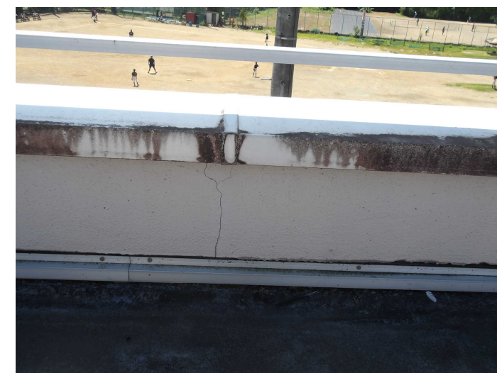
パラペットのき裂
