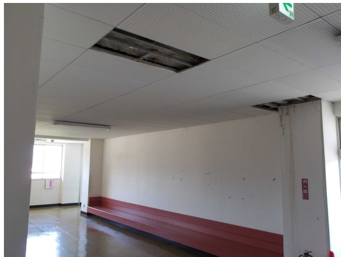
廊下：天井の漏水
