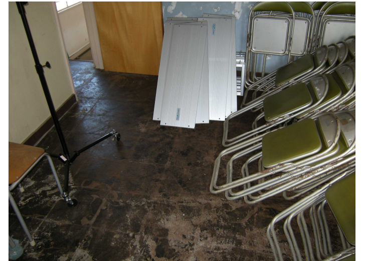
ステージ裏：床材の欠損
