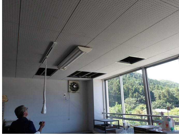
教室：天井の漏水
