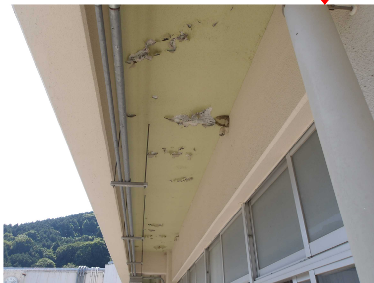
軒裏：塗装の剥離、剥落
