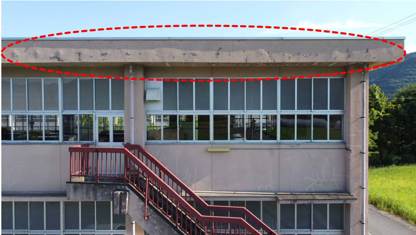
外壁の変形、浮き
