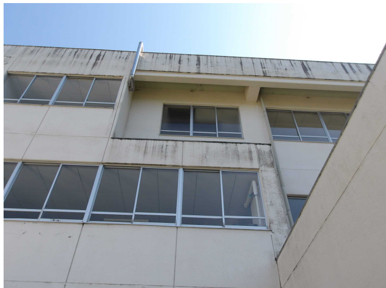
校舎裏：外壁の汚損
