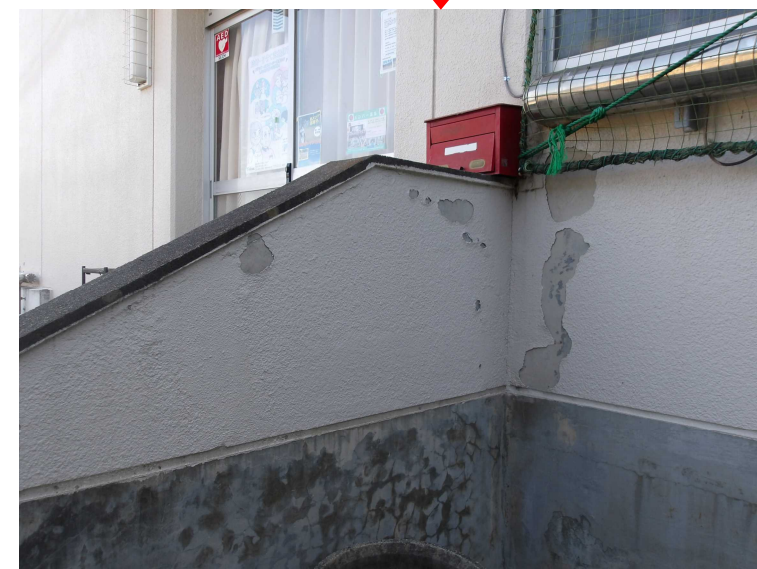
塗装の剥離、剥落
