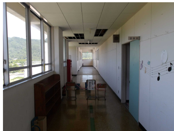
↑ 廊下：天井の漏水
