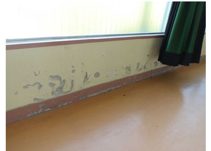
内壁：塗装の剥離、剥落
