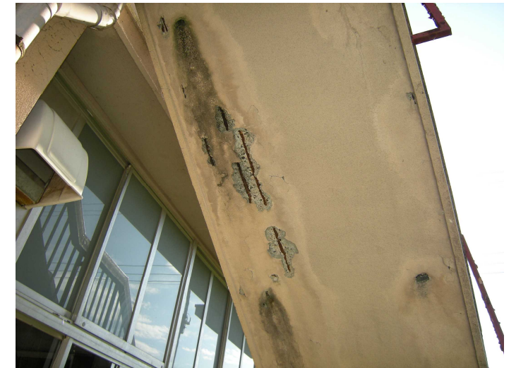
階段裏：鉄筋の露出、漏水痕
