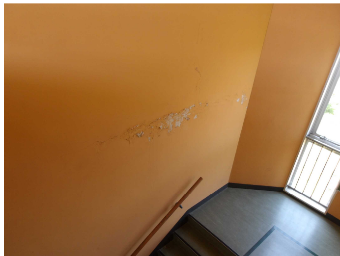
内壁：塗装の剥離、剥落
