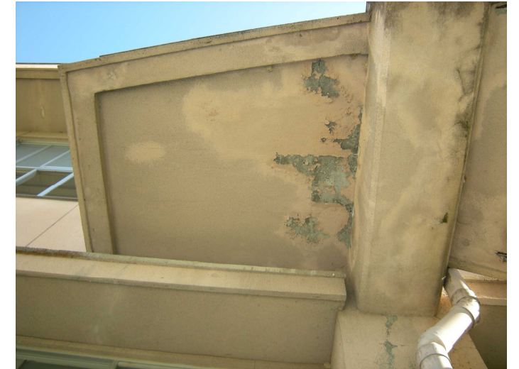
軒裏：塗装の剥離、漏水痕
