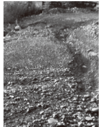
大雨のたびに表土が流される町道
